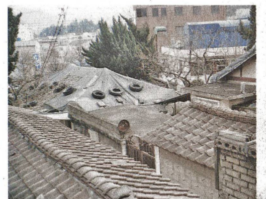
너무 낮아서 비가 새 지붕을 비닐로 덮고 페타이어로 눌러놓았다.
